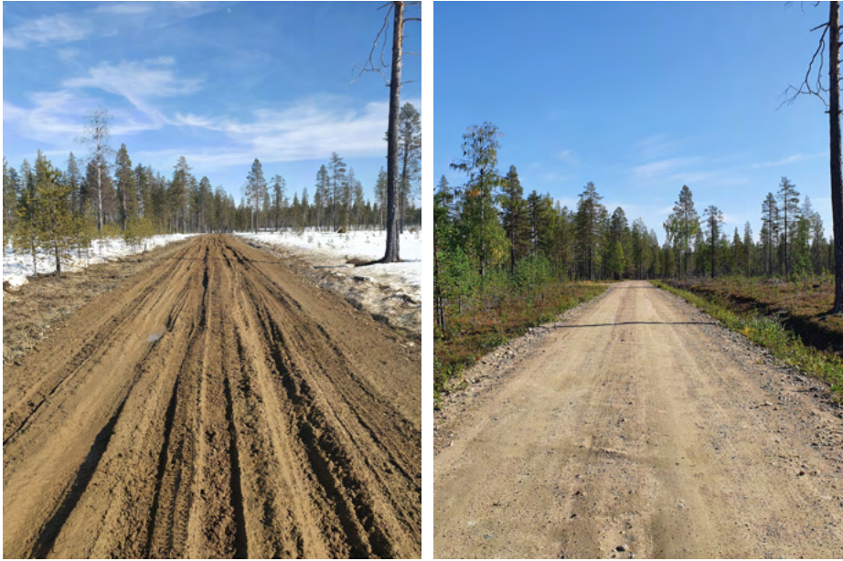
Vaurioitunut tie ja sama tie korjauksen jälkeen. Kuvat: GeoPool Oy.
